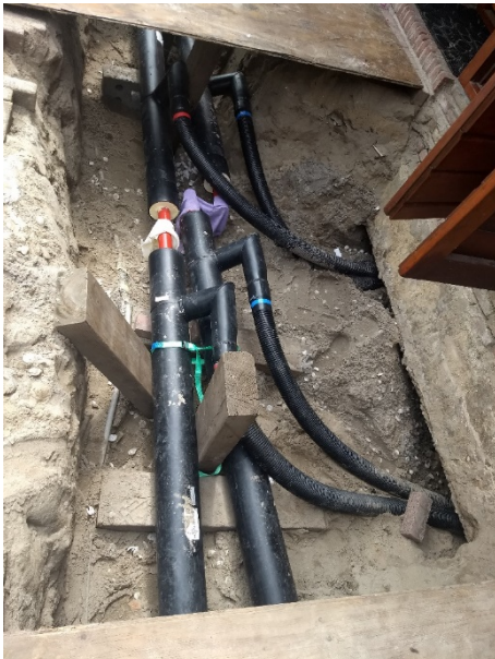
Figuur 58: Flexalink2 Kunststof prefab netwerk in bestaande bouw
